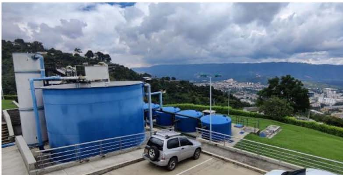
Sistema de acueducto de la empresa Aqualia.
